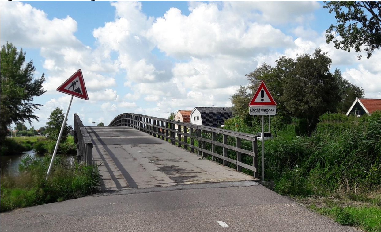
Figuur 4.12: Fietsbrug over de Delft is in zeer slechte staat
