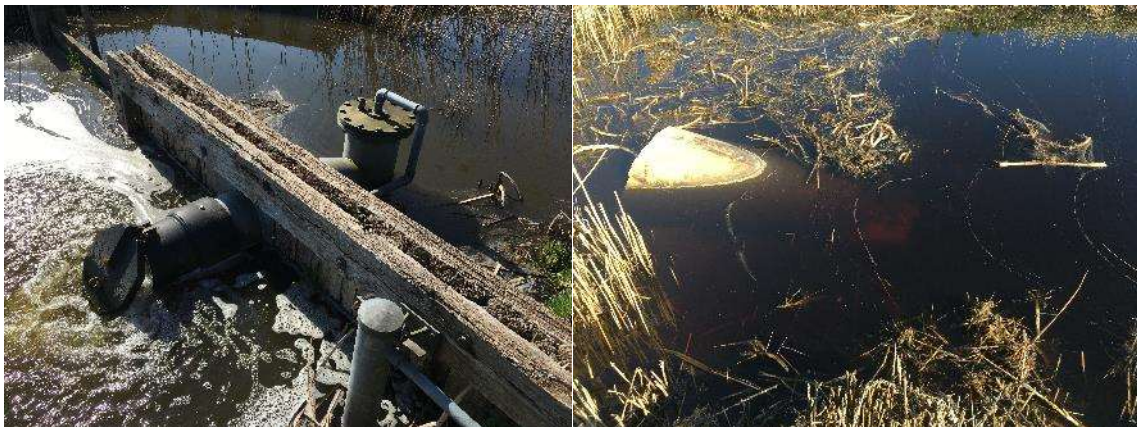
Afbeelding IV.3 Links de visvriendelijke pomp en rechts een relatief heldere watergang in de Munt (de buis is een beschadigde duiker)
