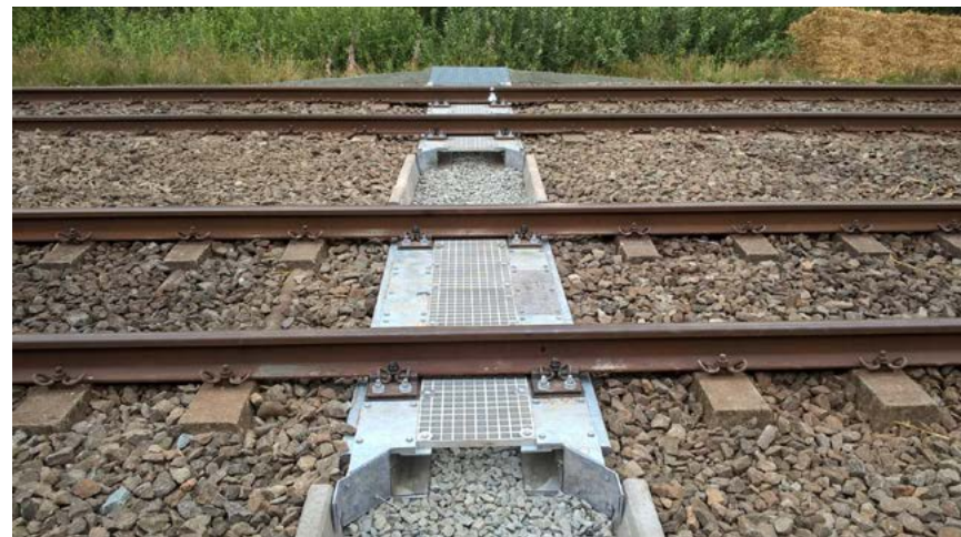
De dwarsligger faunapassage is een onderdoorgang op dezelfde hoogte als het spoor.
