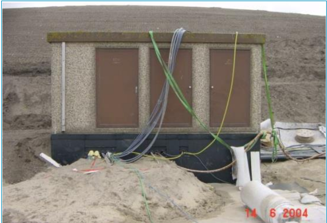
HDPE-plaat ter plaatse van verdeelstations
