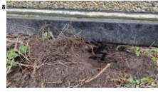
HDPE rand vrijgegraven, achter de rand zit een tweed kan één en ander onafhankelijk van elkaar schuiven.
