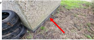
Kieren tussen gebouw en HDPE opstaande rand (foto van november 2022)
