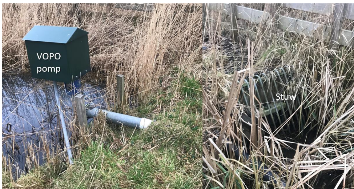
Afbeelding 3.11 VOPO pomp aan de zijde van het bakje en handmatige stuw aan de zijde van het Markermeer
