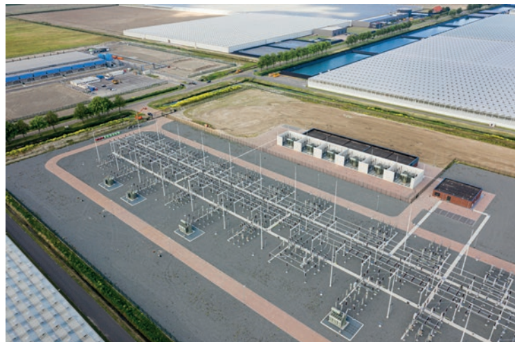
Transformatorstation in bedrijventerrein/kassencomplex, Middenmeer. Bron:Tennet
