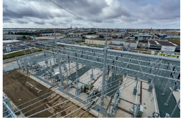
Transformatorstation in bedrijventerrein. Bron: TenneT
